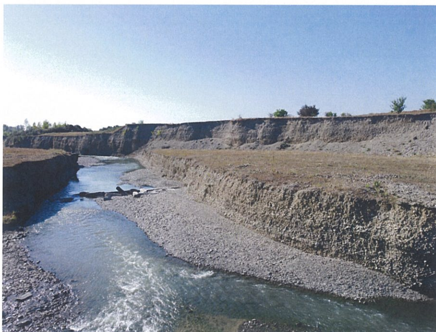
Albia râului Prahova aval de baraj și eroziuni active de maluri
